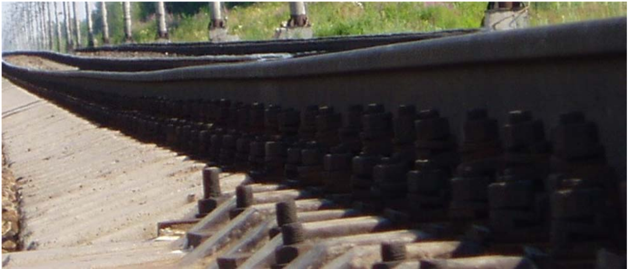
Рисунок 3.11 – Фото неровностей на подходе к мосту через реку Шошу на Октябрьской железной дороге
