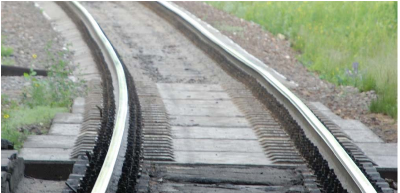
Рисунок 1.6 – Предмостовая яма в зоне сопряжения железобетонных плит и шпал (фото автора)
