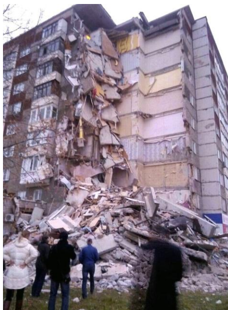
Рисунок 3.21 – Обрушение части жилого крупнопанельного дома в г. Ижевск
