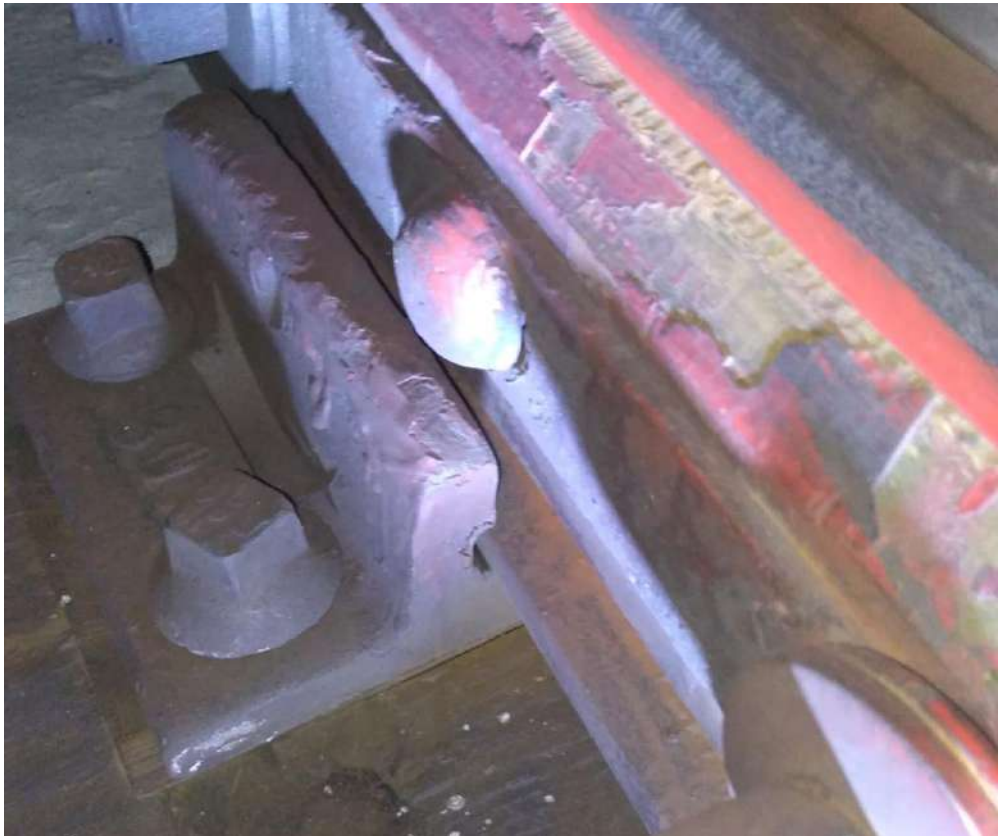
Рисунок 1.6 – Износ 8 мм боковой реборды подкладки типа «метро» в зоне изолирующего рельсовые цепи стыка типа «АПТЭК».
