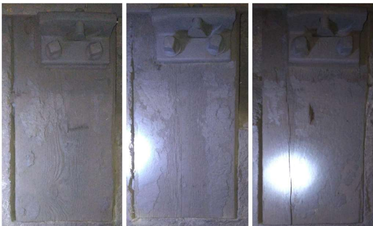
Рисунок 1.2 – Потеря связи деревянных шпал с путевым бетоном. Зазоры до 20 мм в зоне контакта.
