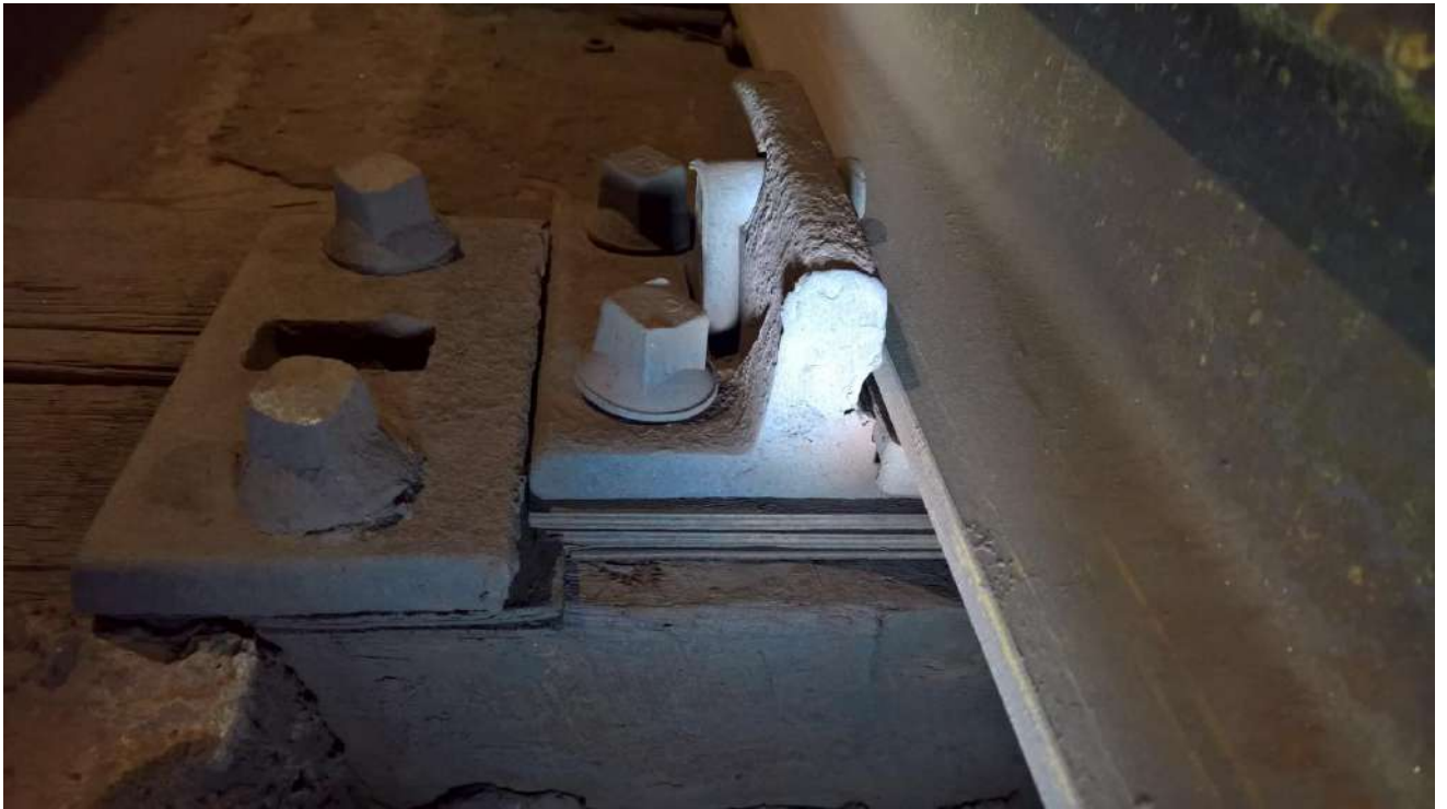
Рисунок 1.5 – Износ 5 мм боковой реборды подкладки типа «метро».
