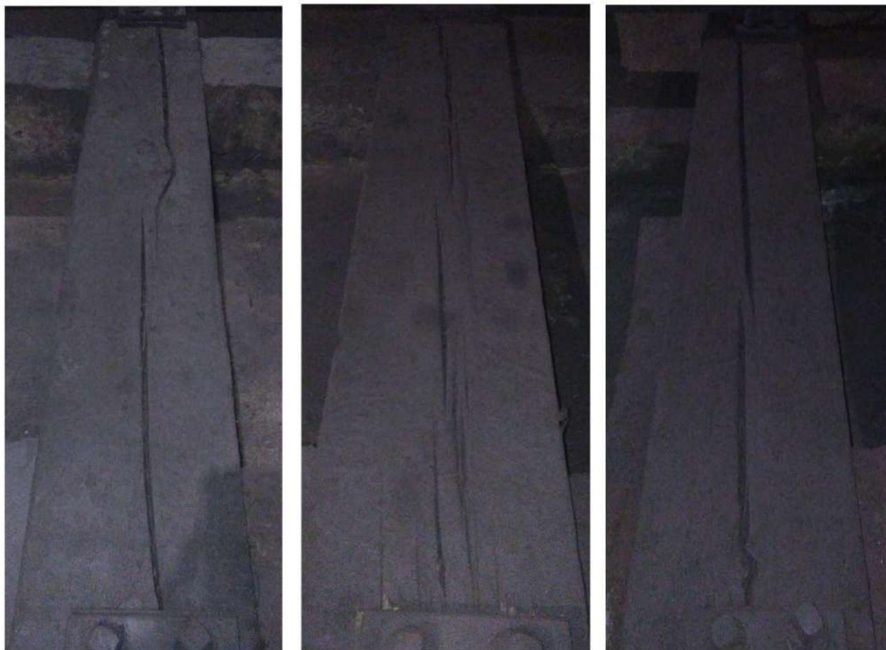
Рисунок 1.3 – Продольное растрескивание шпал. Трещины шириной до 1,8 см.
