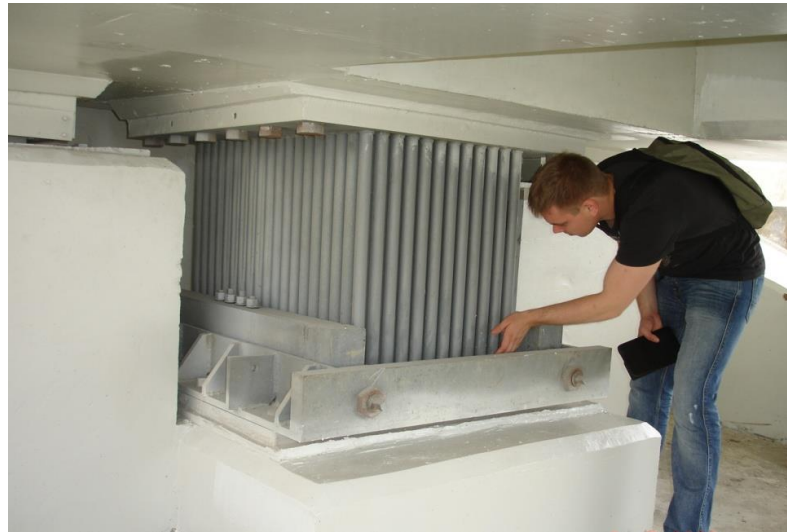
Рисунок 9 - Вид установленной податливой опорной части в виде стержневого амортизатора
