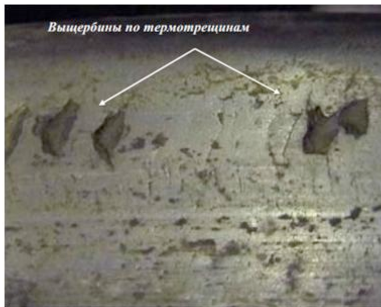
Рисунок 1.11 - Выщербины по термическим трещинам
