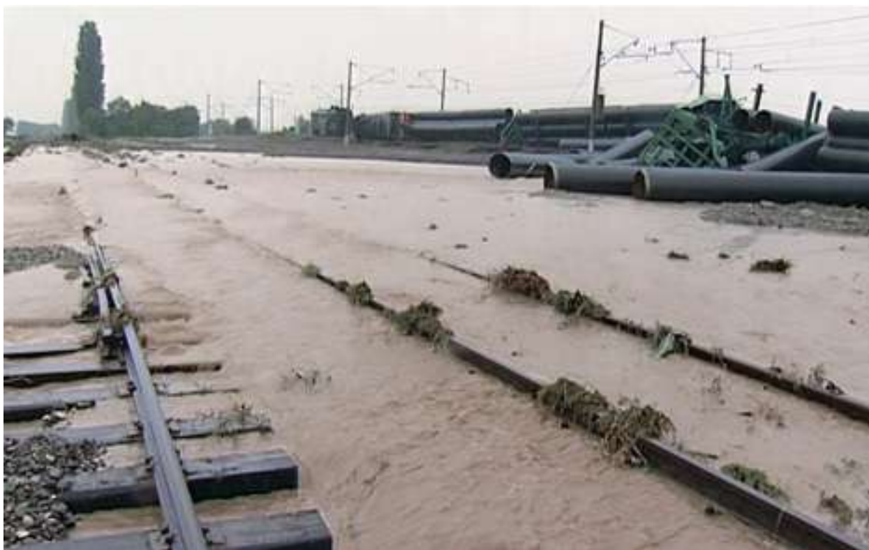
Рисунок 1.4 – Подтопление железнодорожных путей в Палласовском районе Волгоградской области
