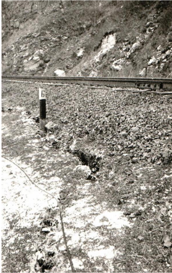
Рисунок 2.3 – Трещина по обочине полунасыпи
