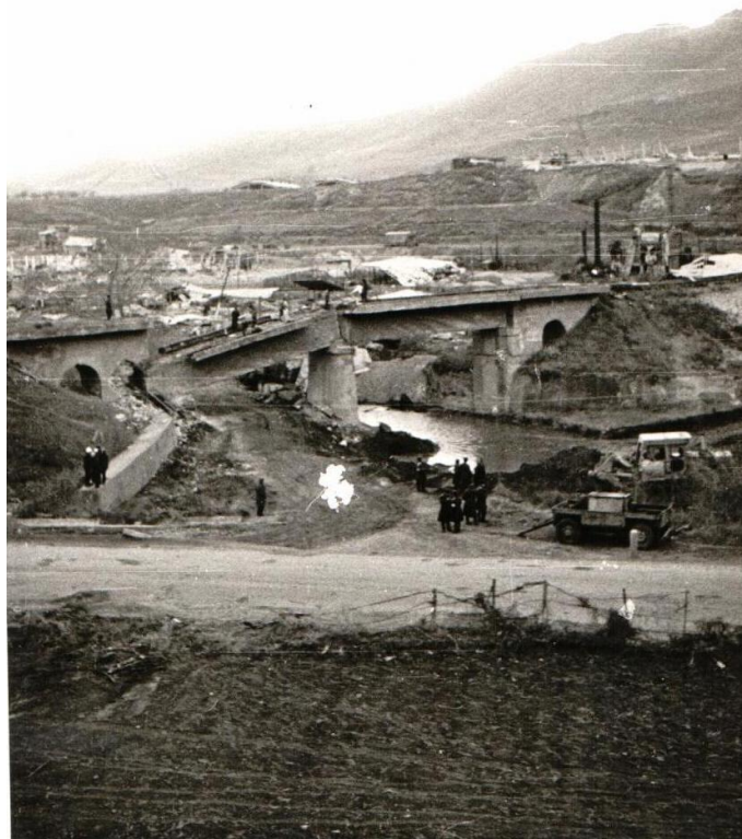
Рисунок 2.4 – Повреждение опоры моста подъездного пути к сахарному заводу в г. Спитак
