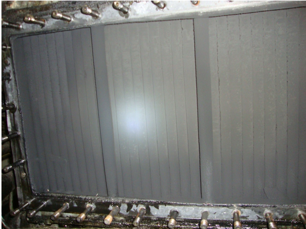
Рисунок 16 - Внешний вид охлаждающих трубок охладителя наддувочного воздуха до промывки
