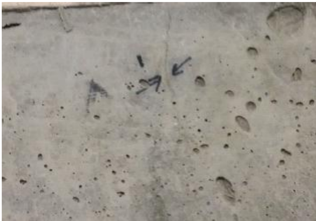
Рисунок 4.55 – Контрольный образец без видимого залечивания трещин
