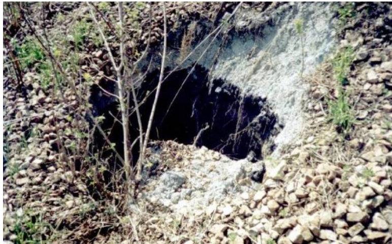
Рисунок 5.31 – Провалы на откосах насыпи
