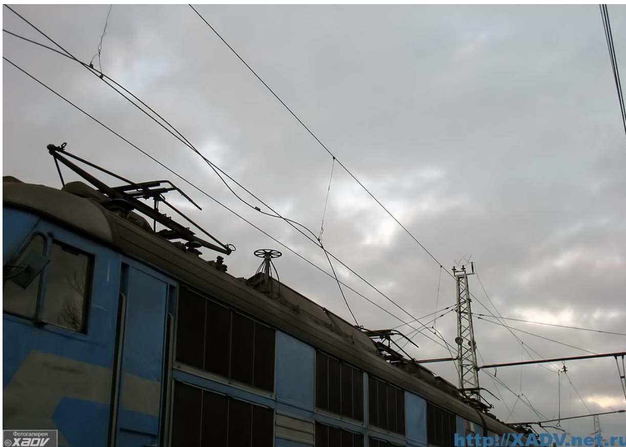
Рисунок 14. Обрыв контактного провода
