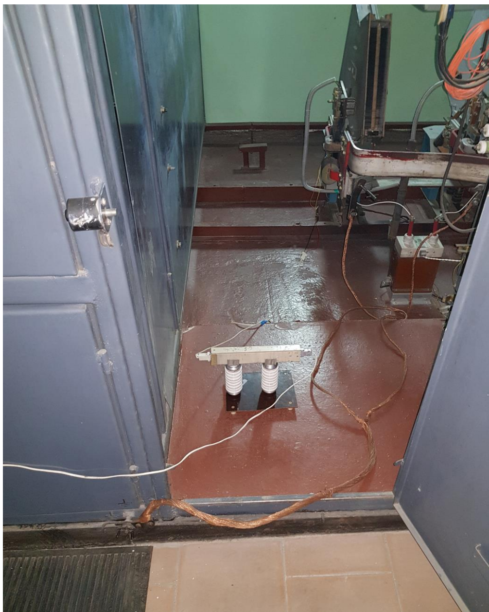
Рисунок 60. ВАБ-49 действующей тяговой подстанции, оборуданный схемой блокировки с РДШ(М)
